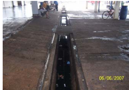
Gambar 5.9. Saluran air yang tidak diperhatikan kebersihannya
