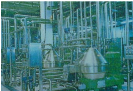
Gambar 3.4 Instalasi peralatan pada pabrik bir
