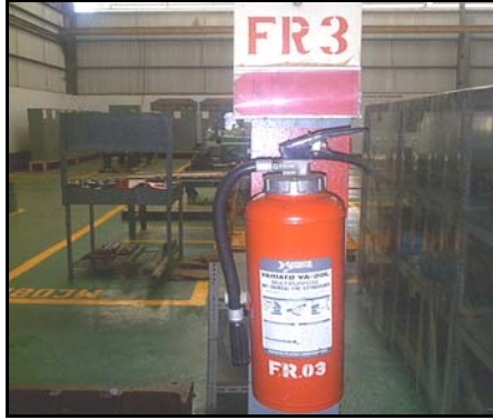
Gambar 5.12. Tabung Pemadam Kebakaran (PT. Pulau Sambu, tanpa tahun)
