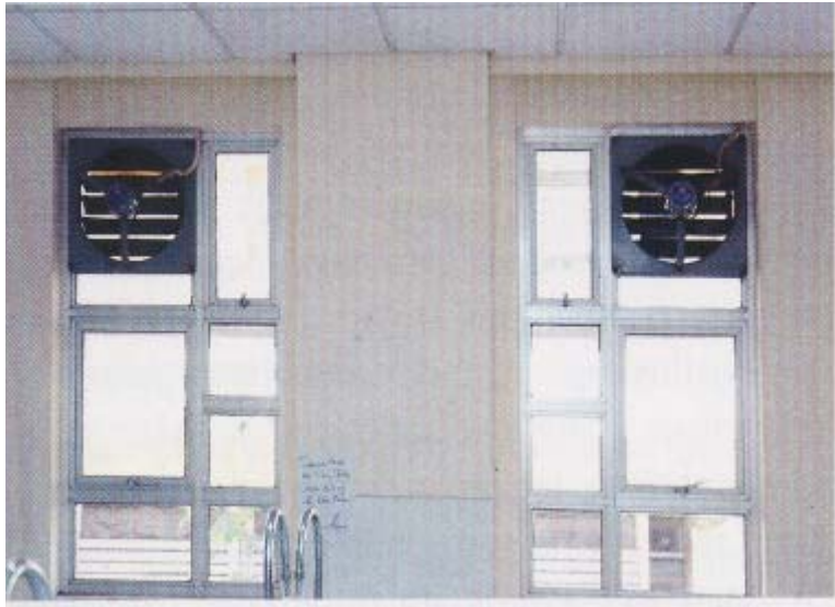
Gambar 5-27. Kipas sirkulasi udara pada laboratorium kimia
