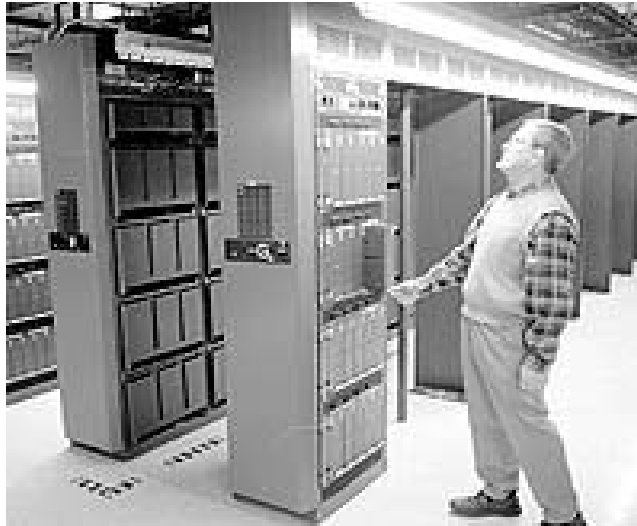
Gambar 10.16 Seorang sedang memeriksa switching digital
