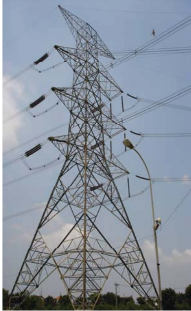
Gambar 4.31 Isolator yang terpasang pada tension tower type DD
