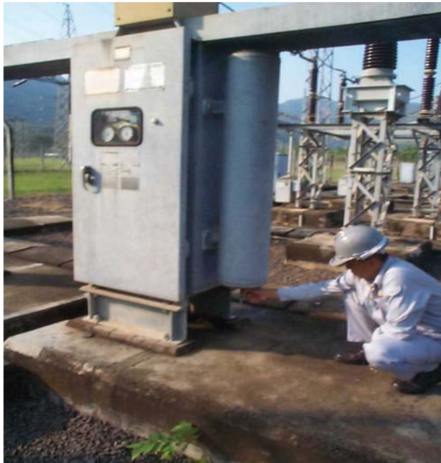
Gambar 5.32 proses drainase air yang terkondensasi dari dalam tangki udara
