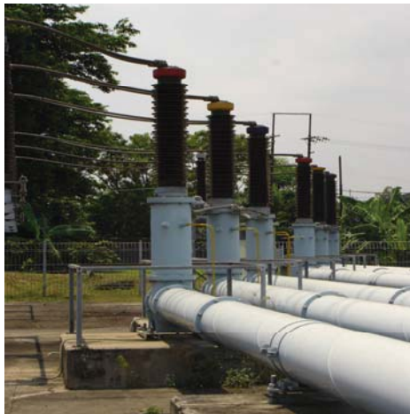
Gambar 4.5. Saluran Isolasi Gas
