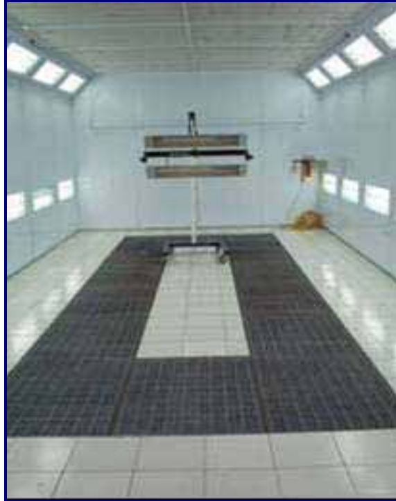
Gambar 17.8 Bagian dalam ruang cat ( Spray Booths )
