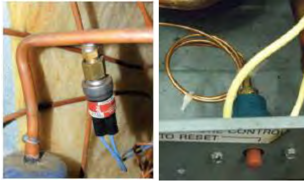
Gambar 5.14 Low-pressure Switch pada Unit Tata Udara Domestik
